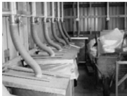
Udsugningen er iorden i rummet for farligt affald.
